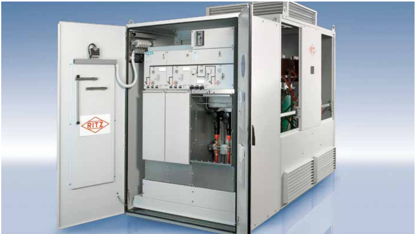
Transformator mit SF6 - Schaltanlage 2000 kVA 11kV/415V DTR102000
